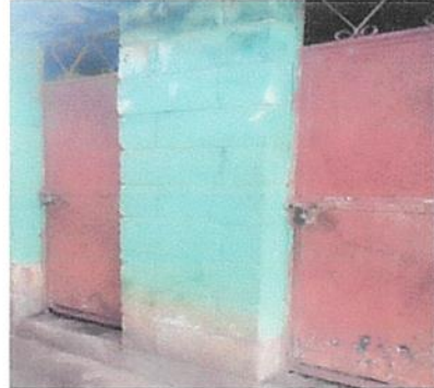
Foto 2: DETERIORO DE PAREDES Y PUERTAS DE BAÑOS
