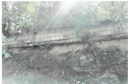
Foto 4: DAÑO EN EL MURO
