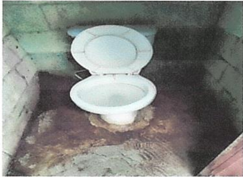
Foto 1: COLAPSO DE BAÑO
