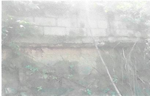
Foto 5: DAÑO EN EL MURO
